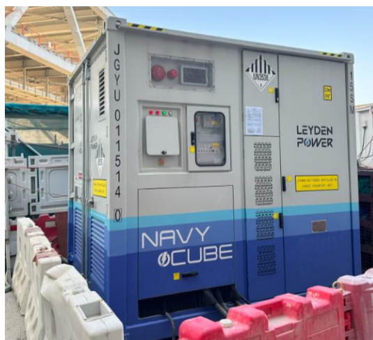
使用流動電源取代發電機
