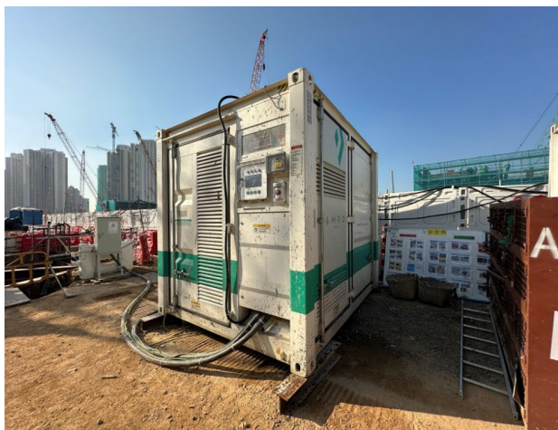
使用流動電源取代發電機
