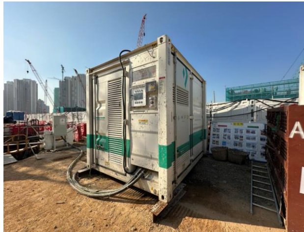
使用流動電源取代發電機
