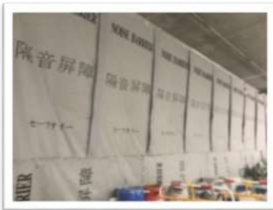
使用隔音屏障
